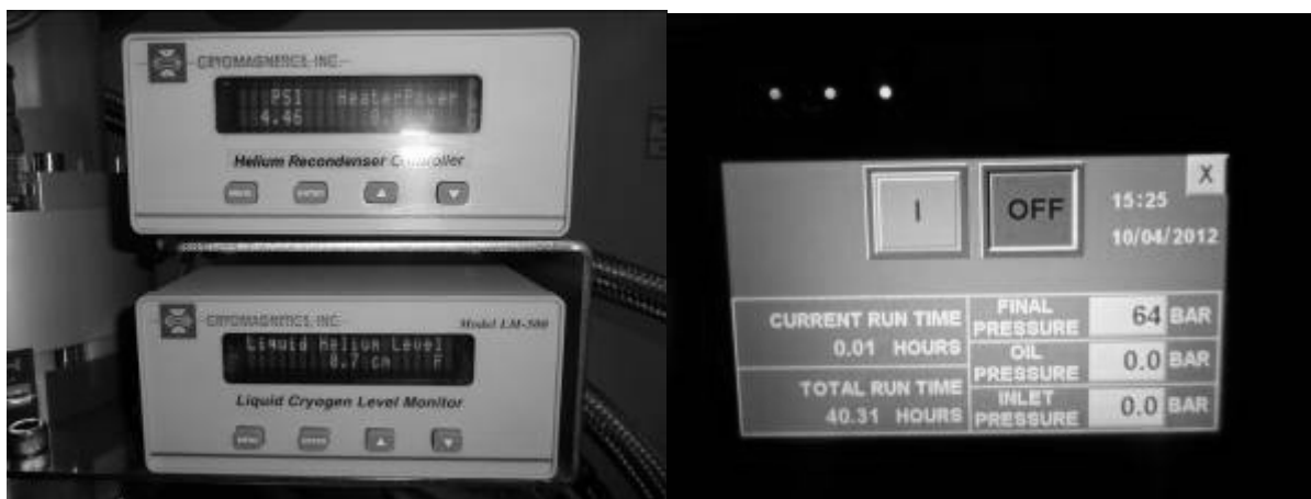
Рисунок 1.12 Панели управления различными частями установки: Блок управления ожижителем (слева) и панель управления закачным компрессором (справа).
